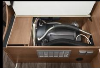
Die im Wohnraum platzierte Dieselheizung
